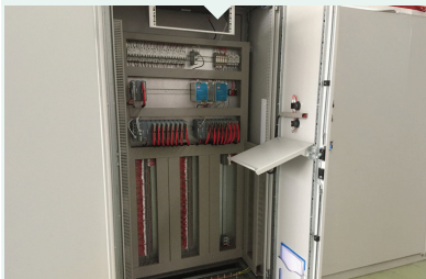
لوحات وحدات المحطات الطرفية البعيدة (RTU)
